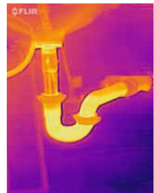
Compruebe fugas de agua
