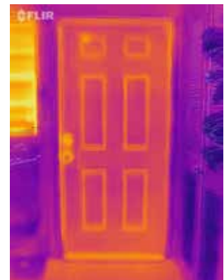
Encuentre señales de fugas de aire y mala instalación
