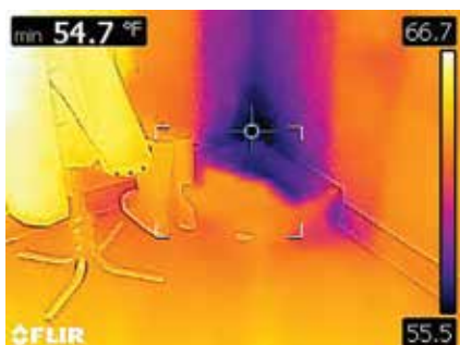
El cuadro de área con puntos fríos muestra la infiltración de aire
