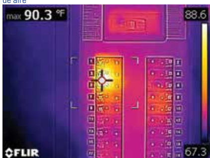
El cuadro de área con punto caliente muestra un fusible eléctrico activo
